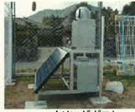
モニタリングポスト (ソーラ発電装備)
