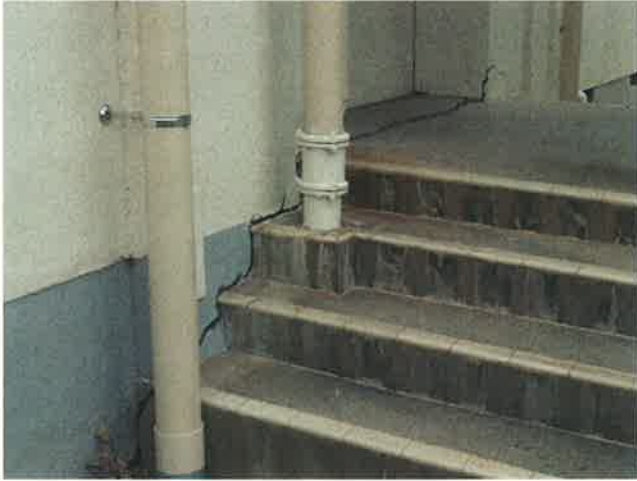
外壁クラック
