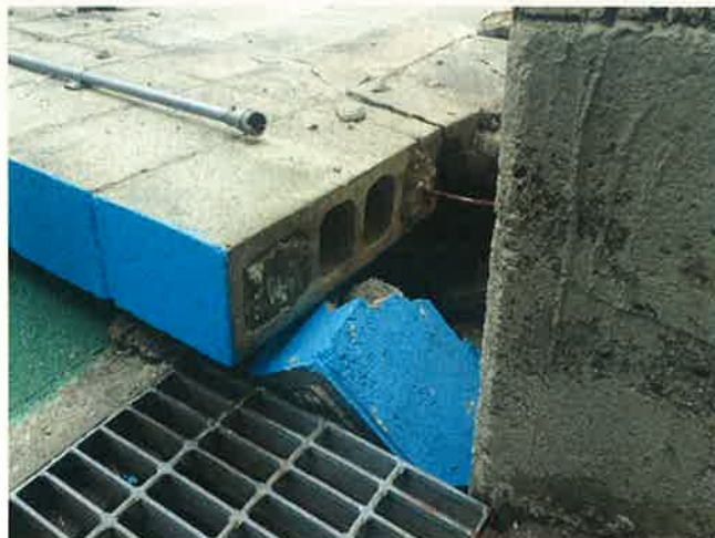
崩壊部（コンクリートブロック側）
