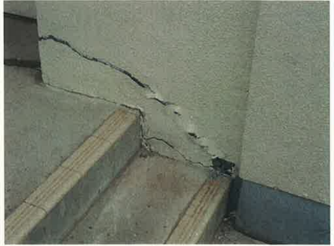
外壁クラック
