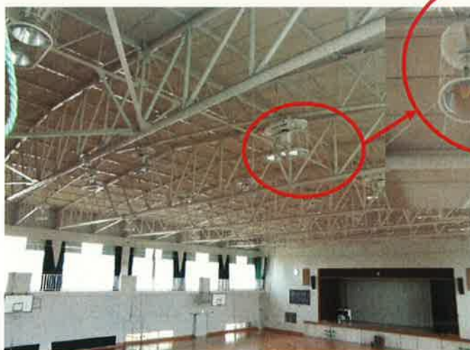
体育館照明器具（水銀灯）
