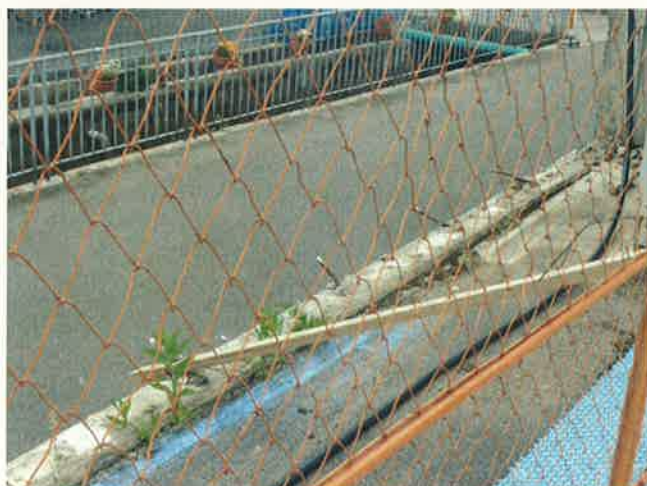
崩壊部（基礎側）
