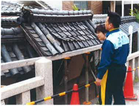
神社の塀が倒壊している
